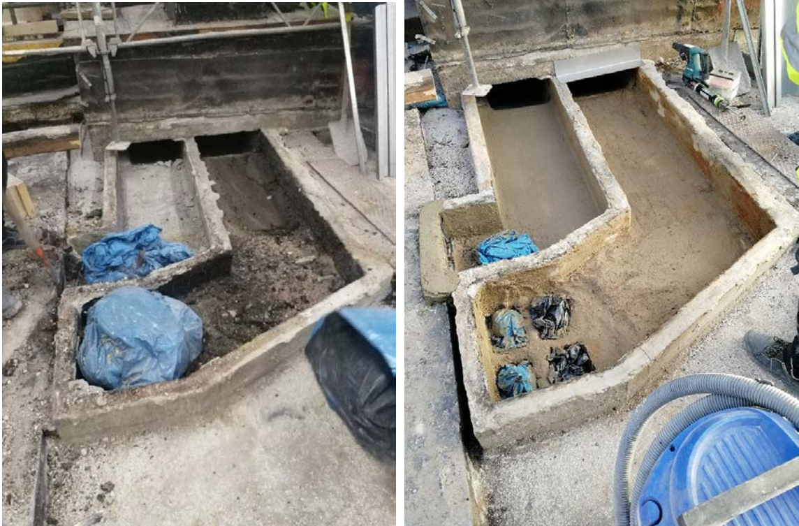
De horisontella rökgångarna och ventilationskanalerna under terrassens ytskikt. Bilden till vänster visar 80 års sotavlagringar som skyfflats(!) ihop innan kanalerna rengjorts och tätats (till höger).
